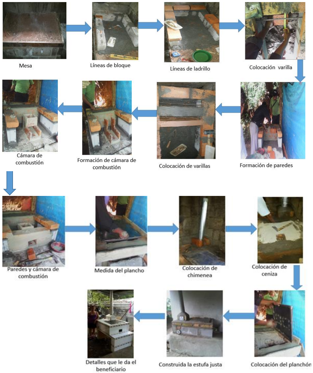
Figura 21. Pasos para las construcciones de las estufas mejoradas que se utilizan en Taulabé y San José de Comayagua
