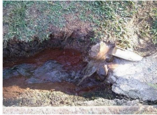
Figura 2 Desagüe en mal estado
