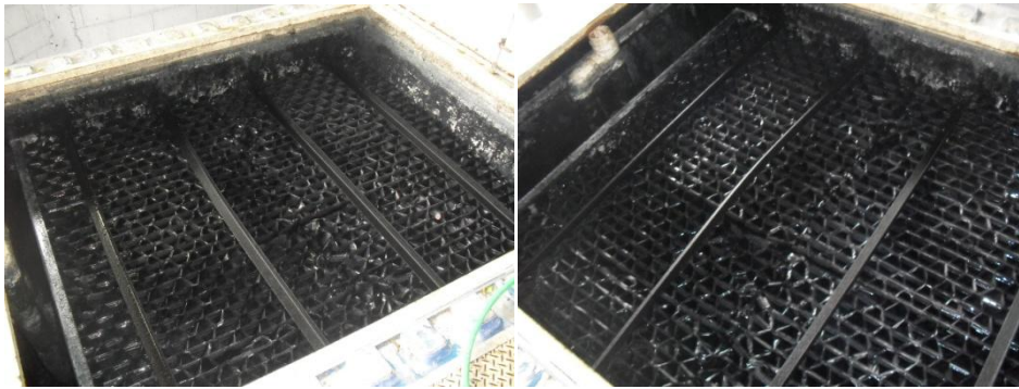
Figura 5. Lamelas separadoras en la celda 4 de biorreactores.
