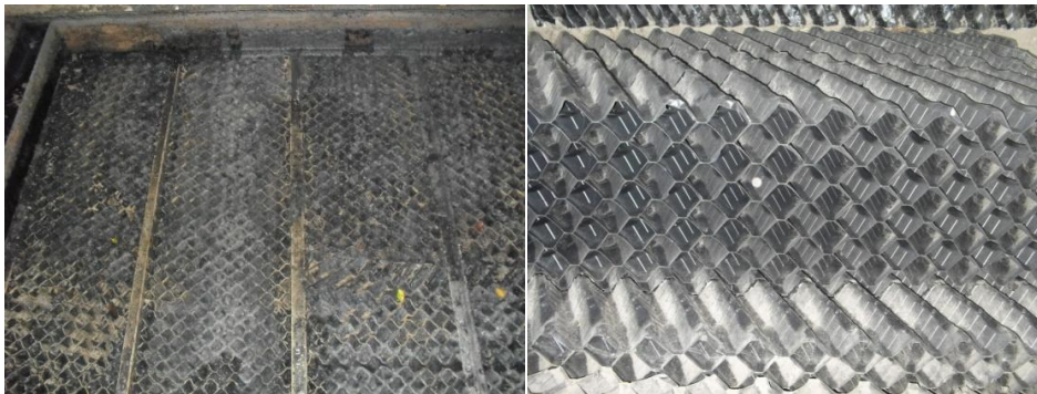
Figura 4. Medio plástico de placa corrugada existente en la celda 3 de biorreactores.
