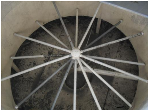
Figura 8. Unidad de flotación actual del DAF.
