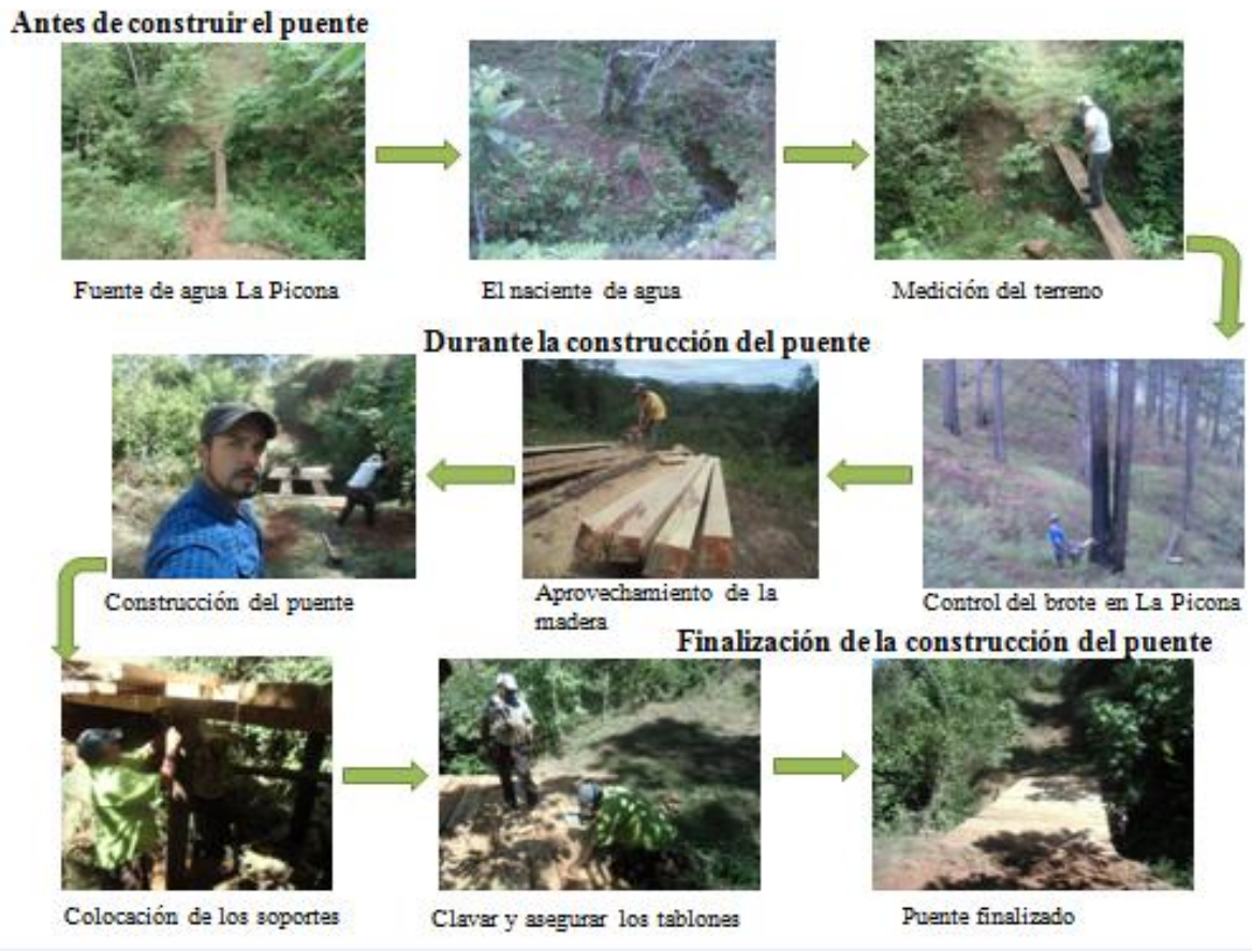
Figura 4. Proceso de la construcción del puente para vehículo pesado en Parque La Piconá
