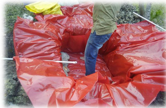
Figura 6. Sistema de cobertura para evitar infiltración, fuente Maricruz Ortega
