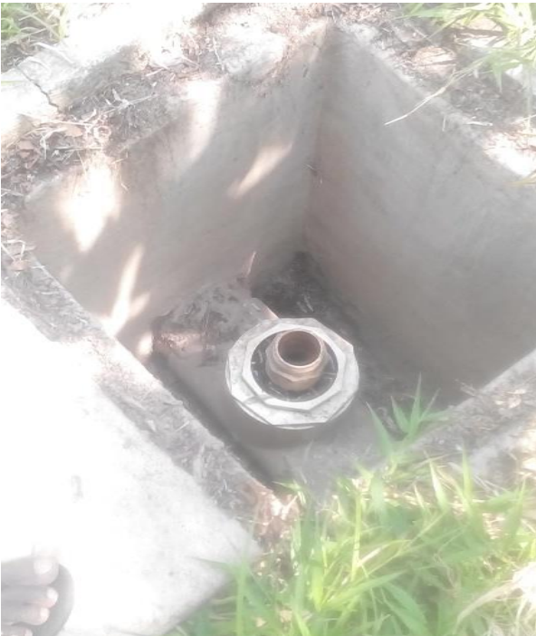
Anexo 9. Válvula de aire vulnerable a daño
