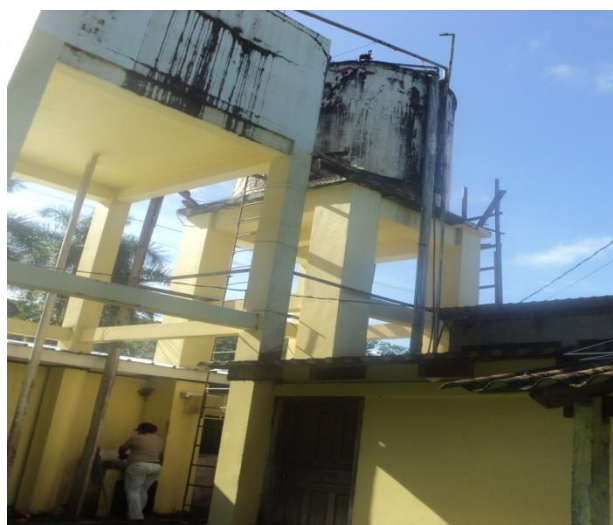
Tanque principal (Cafetería 1)
