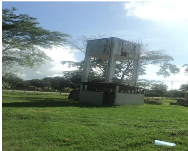
Pozo y Tanque que abastecen H-5
