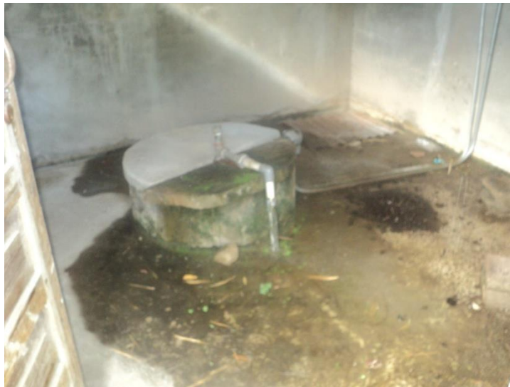
Pozo del CCA
