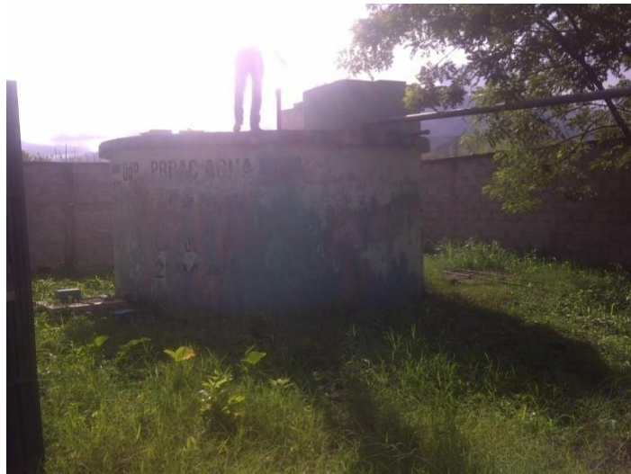
Anexo 52. Tanque de agua de Santa Clara.
