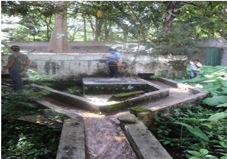
Figura 2. Obra de Toma, fuente de agua la Unión Talgua
