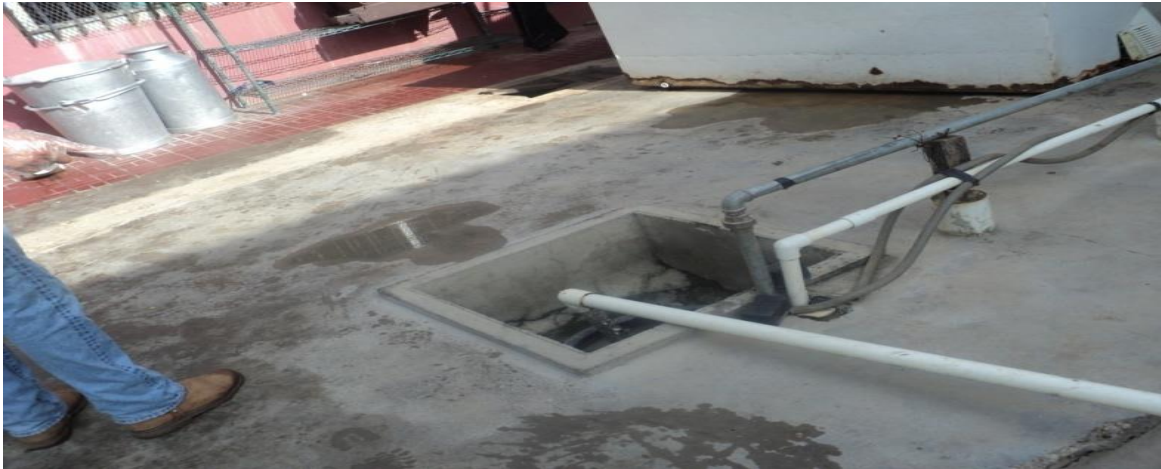
Figura 3. Cisterna del comedor estudiantil
