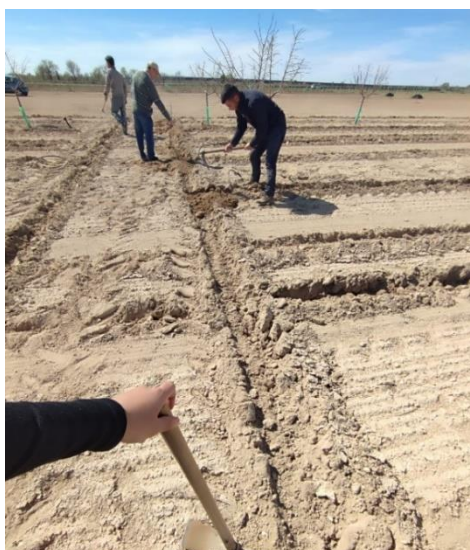
Anexo 10. Sistema de riego por goteo subterráneo
