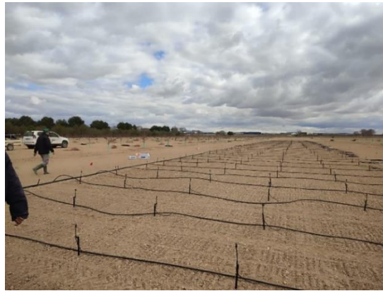
Anexo 3. Sistema de microaspersión instalado
