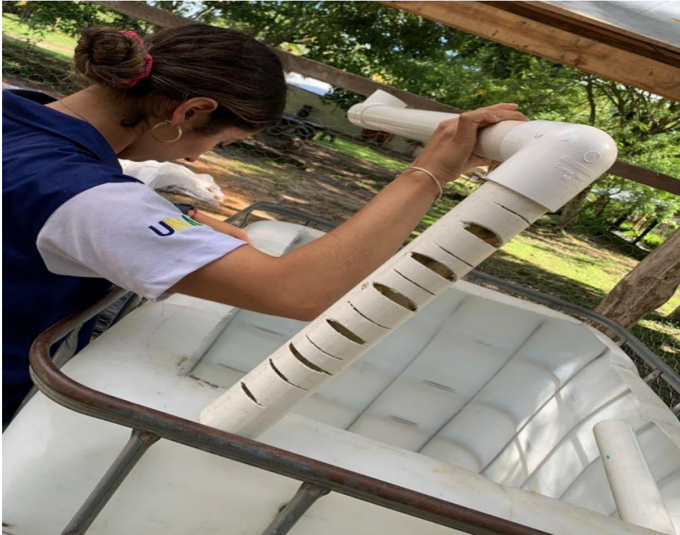
Instalación de tubos con ranuras para la salida de eses de peces
