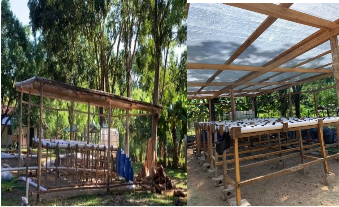
Figura 5. Estructura del sistema acuapónico y galera
