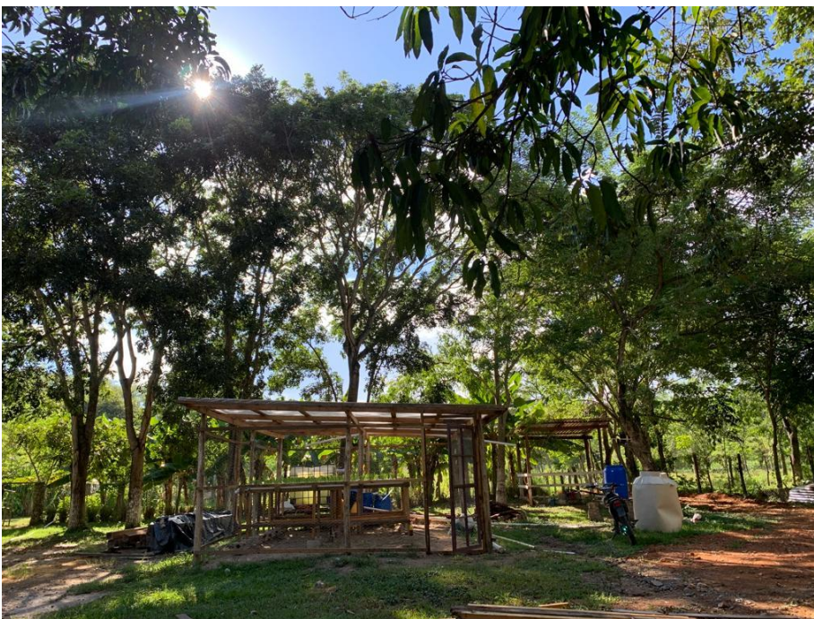
Después de la instalación del sistema acuapónico
