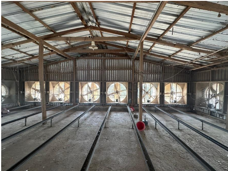
Anexo 1: extractores de sistema de ventilación de presión negativa
