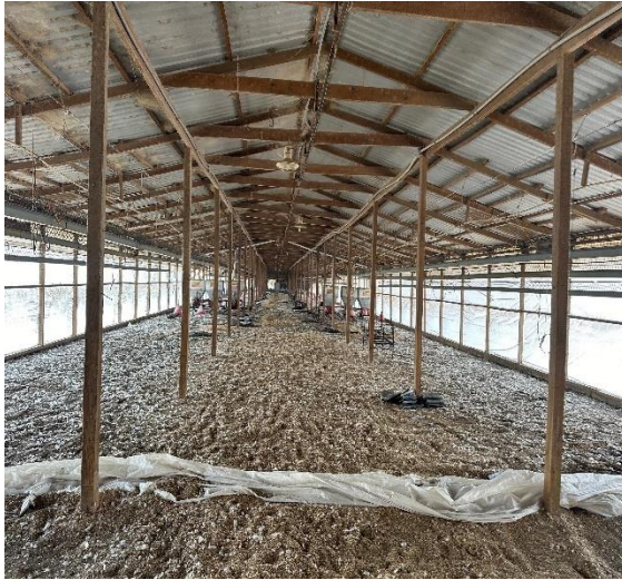
Ilustración 5: Galpón deshabilitado luego de salida del lote
