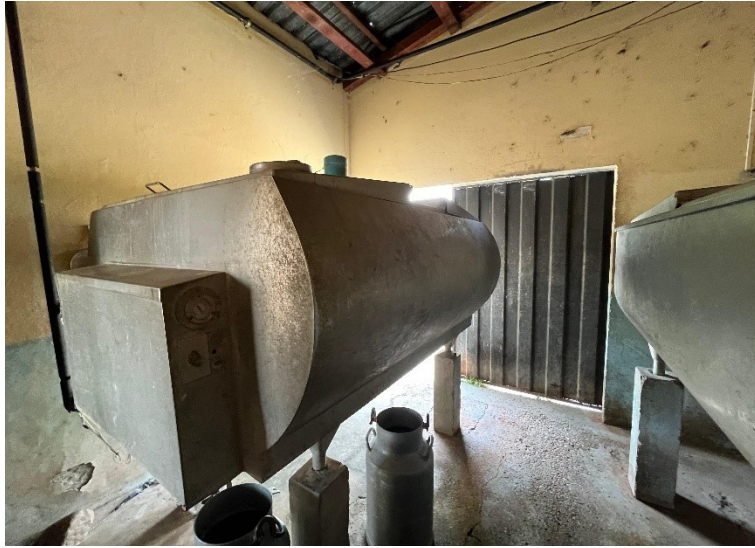
Anexo 11 Enfriadores de leche
