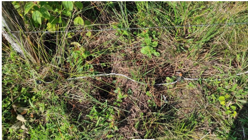
Anexo 4. Varillas del para rayos instalado
