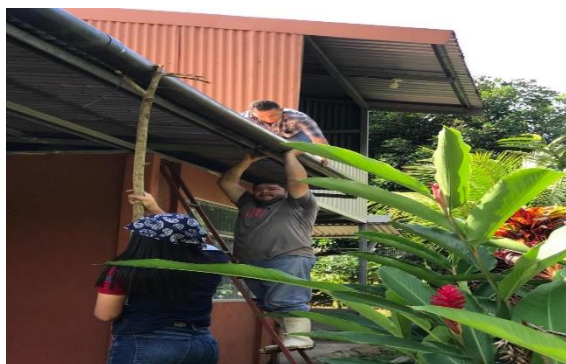
Instalación de cosecha de agua
