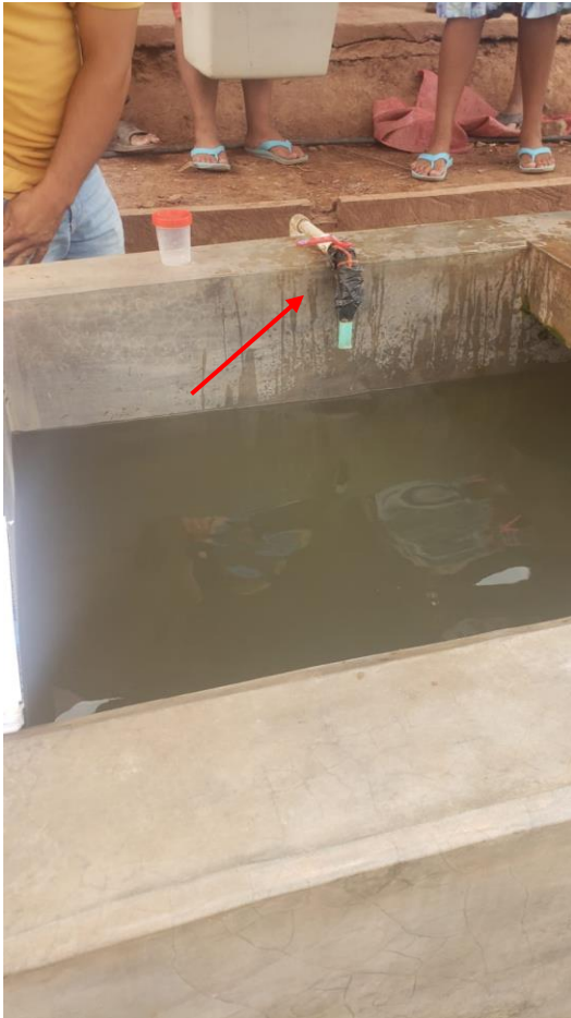
Anexo 13 Contaminación en llaves
