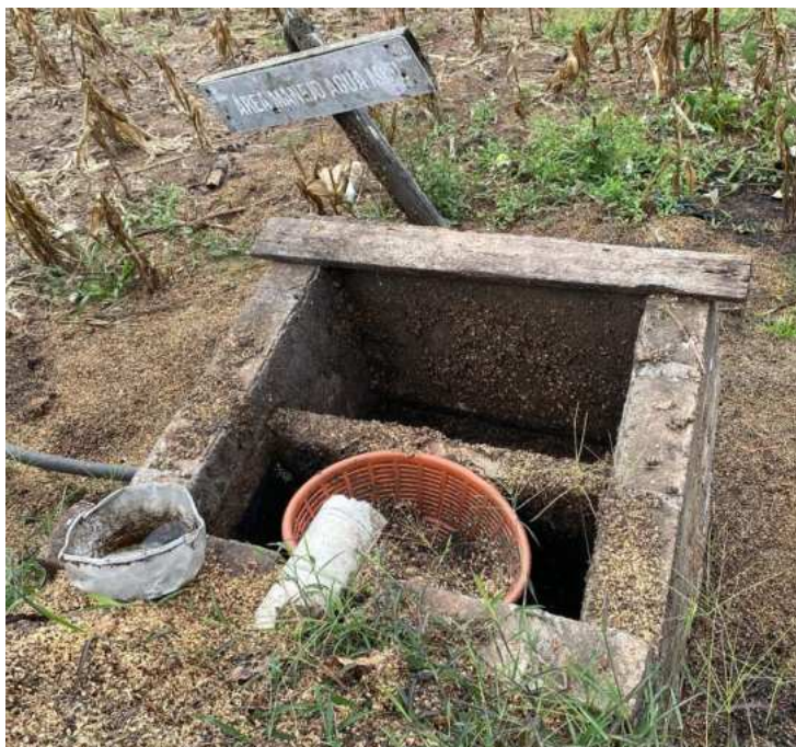
Figura 12. Pila para manejo de aguas residuales.
