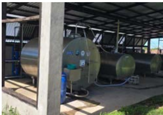
Figura 65. Tanques de almacenamiento de leche producida en la Hacienda El Ciprés.
