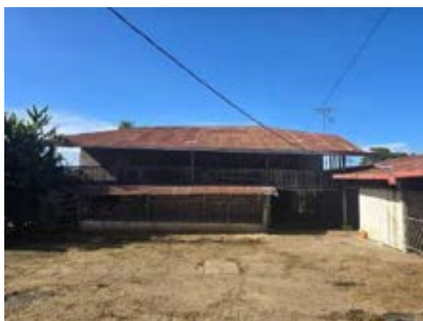
Figura 32. Sistema de captación pluvial mediante techos y canales en la Hacienda El Ciprés.
