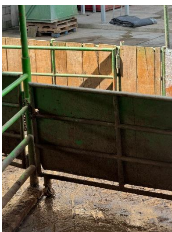
Anexo 2 Ejemplo de acción correctiva portones en mal estado
