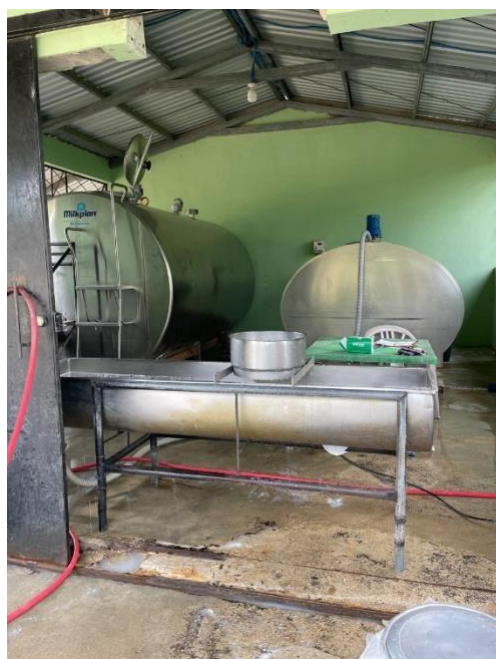
Anexo No. 5 Tanques de enfriamiento y equipo de recibimiento de leche.
