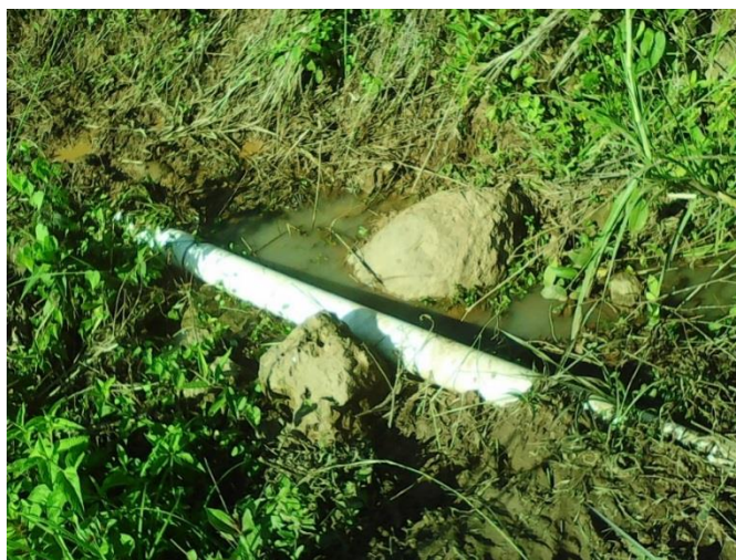
Anexo 15 Tubería descubierta propensa a dañarse en San José San Rafael 22 octubre 2015
