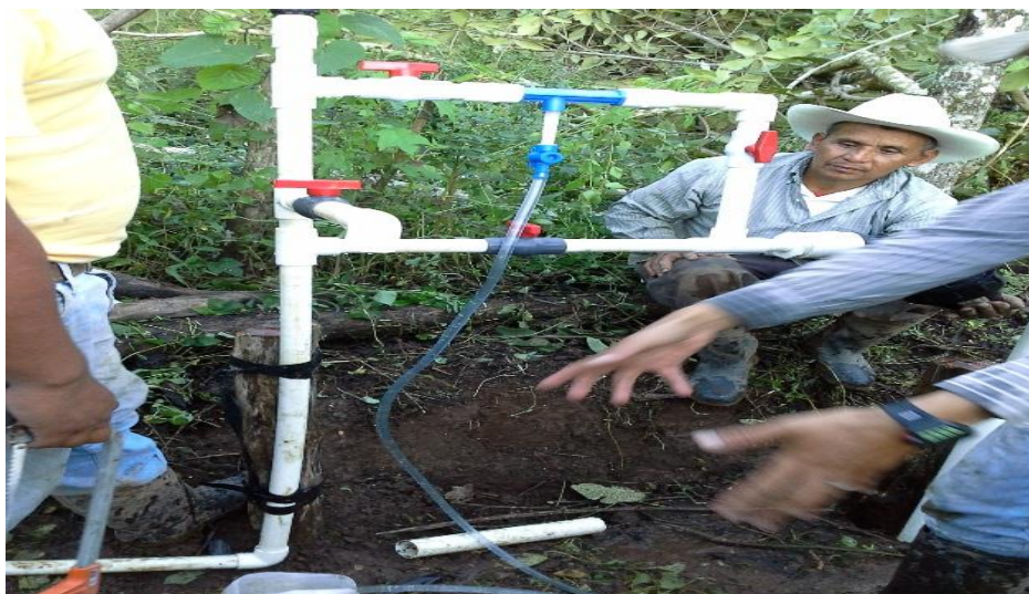
Anexo 6. Instalación de riego por goteo
