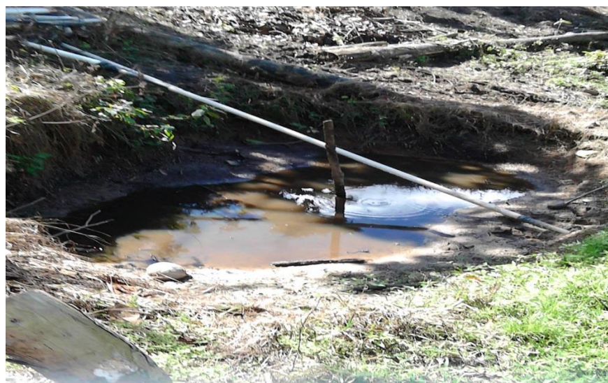
Figura 3. Laguna de oxidación localizada en la aldea San Agustín, municipio de Trojes
