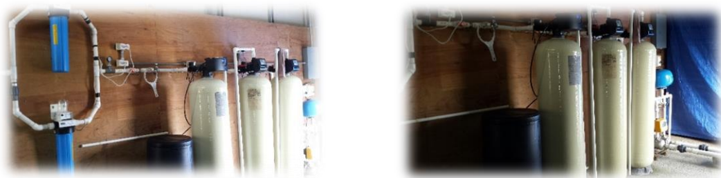
Figura 5. Equipo para el proceso de filtración del agua.
